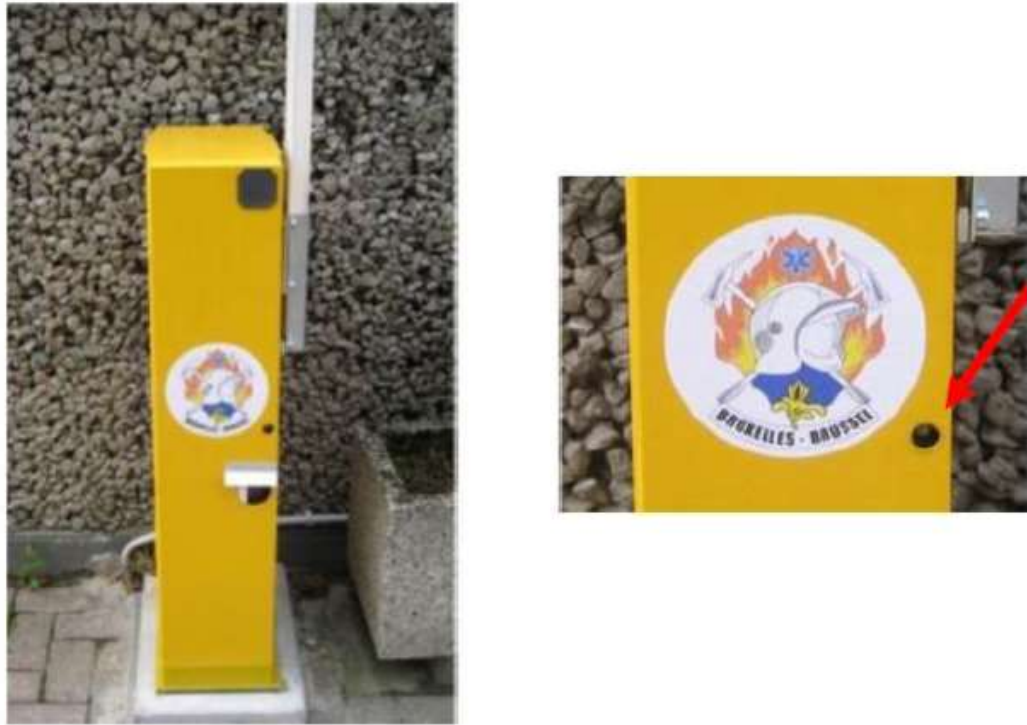
Figure 1 : Exemple de barrière avec clé pompier
