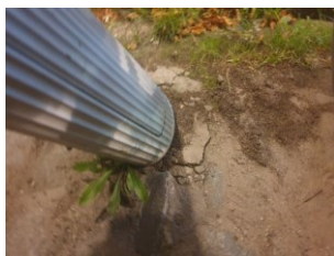
Déchaussement de la bornette (Lyon)
